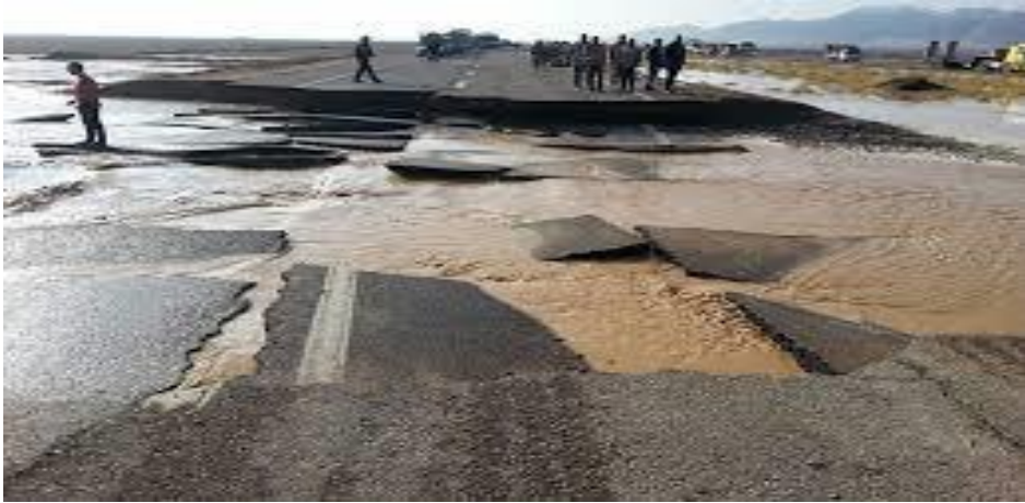
صورة ( 5 ) تآكل وتكسير طريق الشيخ فضل - رأس غارب التقاط الصورة في 8 مارس ، 2015 ، النظر في اتجاه الشرق .
